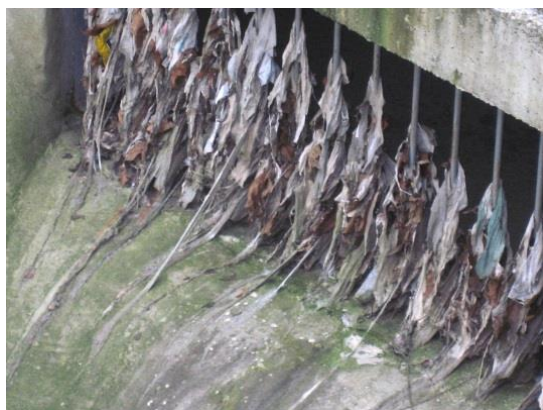
Lingettes obstruant une grille du réseau
