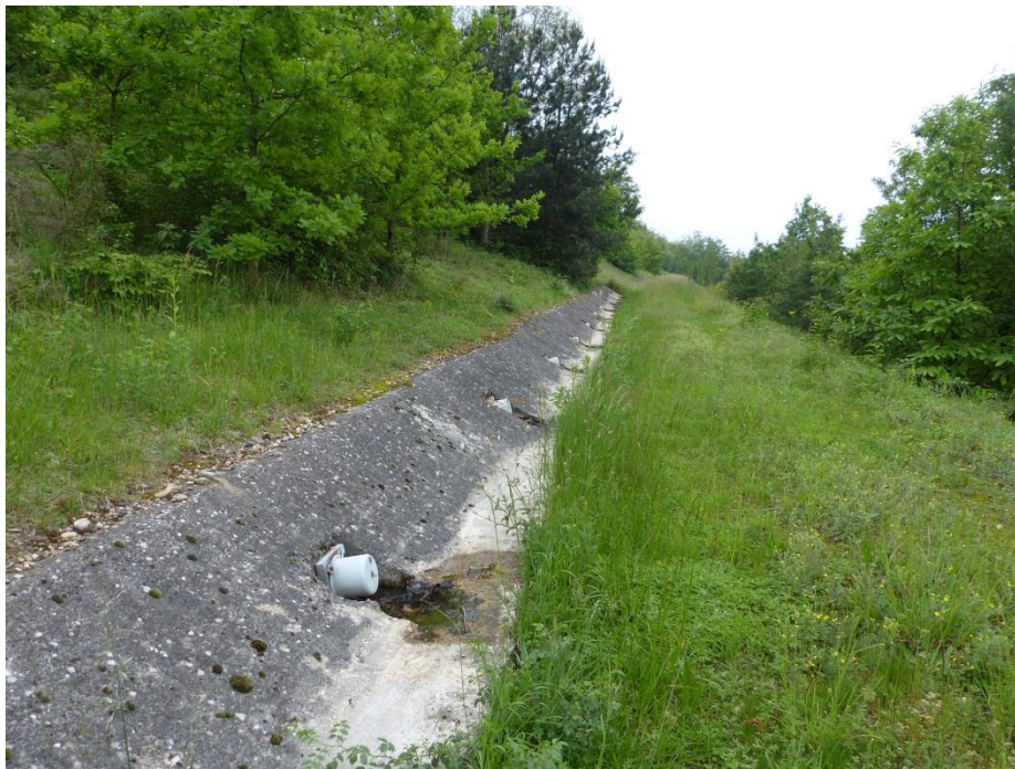
Illustration 11 : Confortement d'un glissement d'ampleur sur le contournement Est de Lyon – commune de Communay (photo BRGM)
